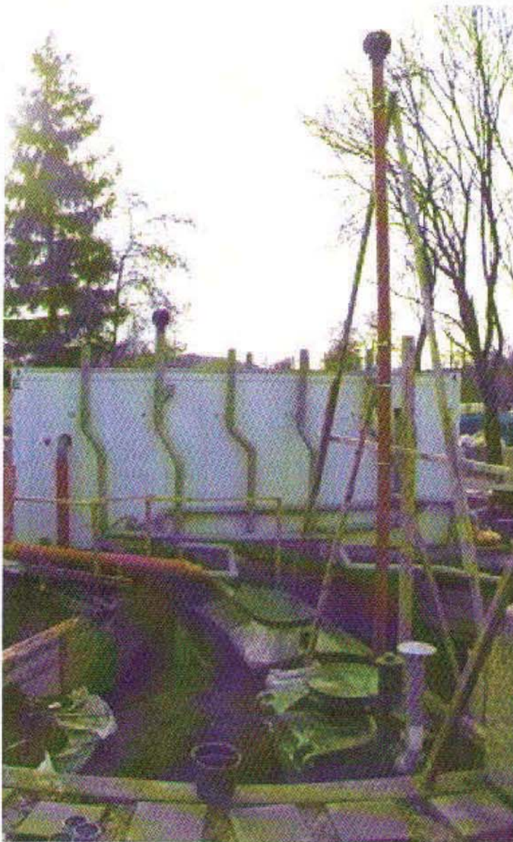
Abbildung 1: Eingebaute Anlage BIOROCK-D5 auf dem Prüffeld PIA GmbH
